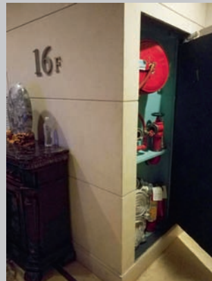
最后取水处 16 楼消防栓。
